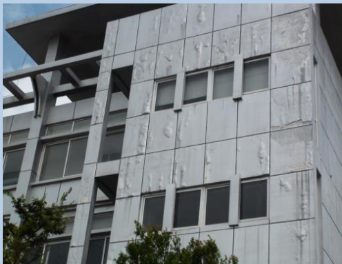
涂料幕墙发生鼓泡脱落、挂污严重现象
